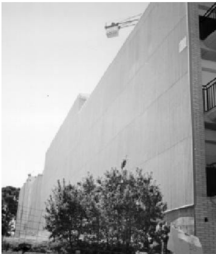
Figura 1. Material de fibrocemento en un edificio en construcción
