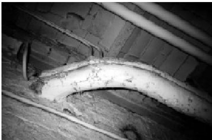
Figura 3. Calorifugado de una tubería con material con crisotilo, que requiere reparación.
